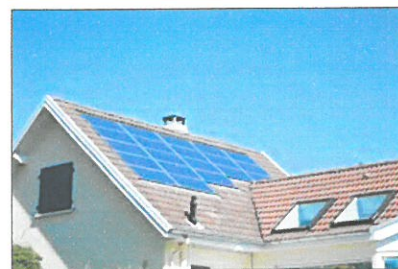
Des panneaux solaires sur le toit d'une maison
